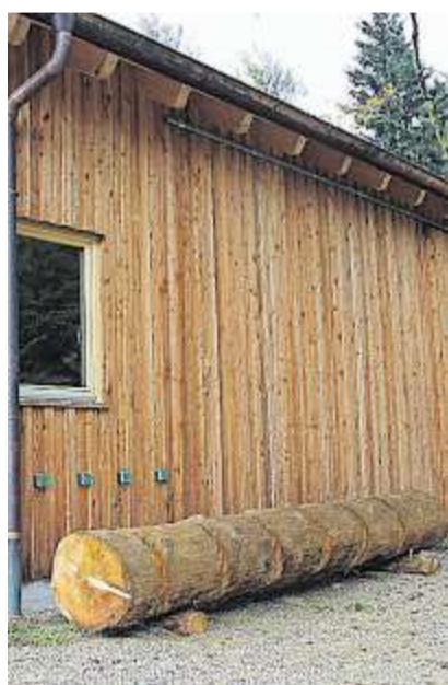
Beim Servicegebäude am Gibacht wurden E-Bike-Ladestationen und ein Fahrradständer installiert. FOTO: FHE
