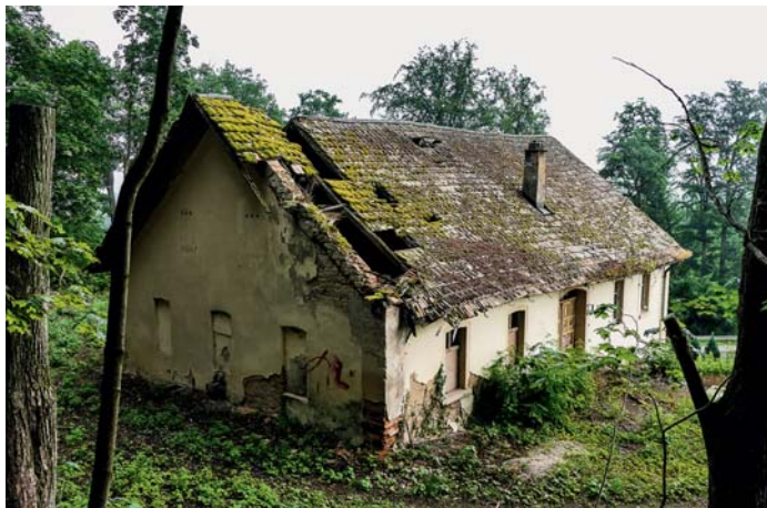
links: Hat schon bessere Zeiten gesehen: Der Fronberger Keller. Seine Tage sind gezählt.
